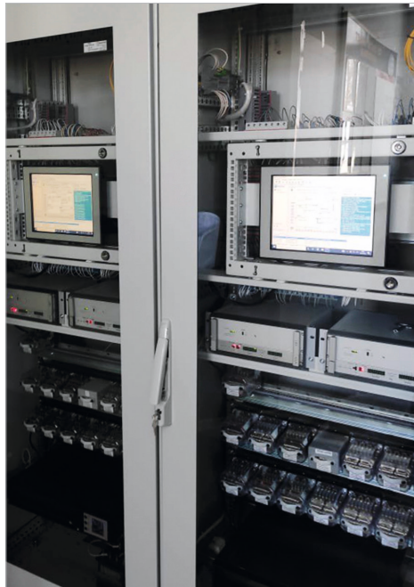
Шкаф МПБ на участке Никельтау – Кандыгаш (Казахстан)
