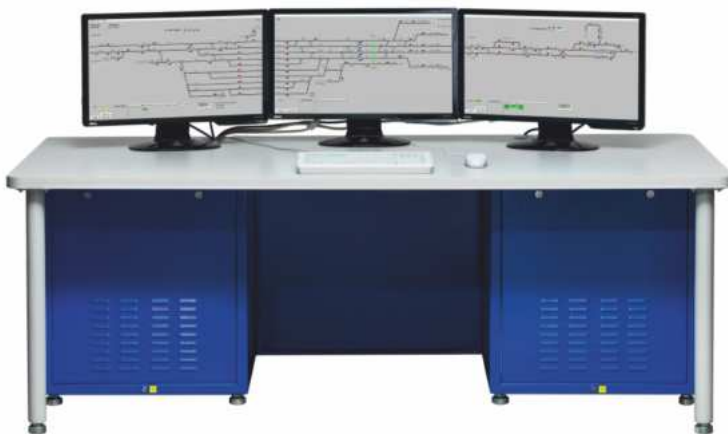
Автоматизированное рабочее место дежурного по станции АРМ ДСП
