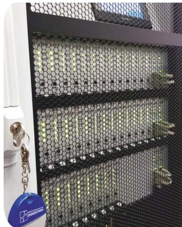
Постовое оборудование системы ЭССО-М-2
