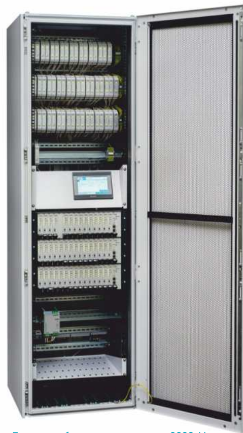
Постовое оборудование системы ЭССО-М
