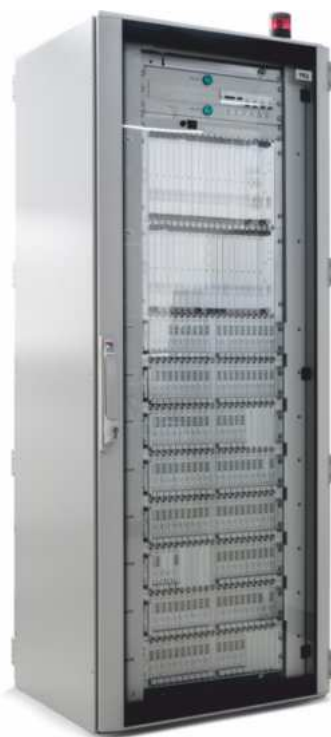
Управляющий контроллер централизации УКЦ
