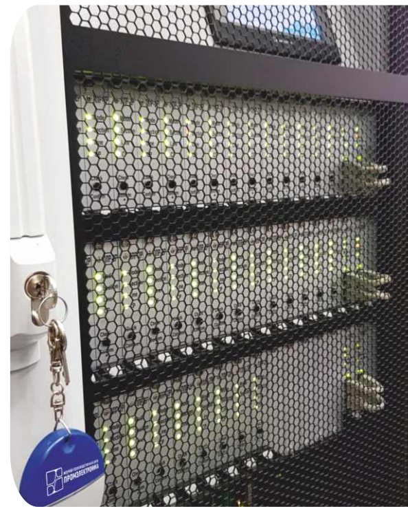
Постовое оборудование системы ЭССО-М-2
