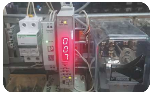
BI Interfacing Unit
