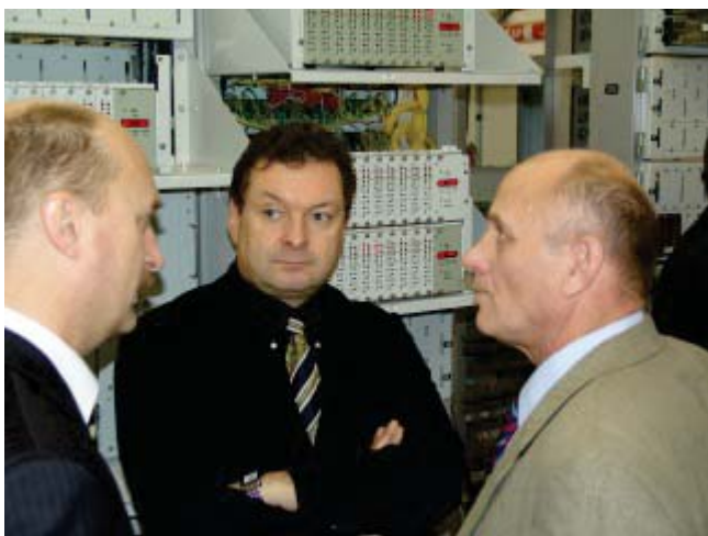
2005 год, комиссия по вводу в эксплуатацию МПЦ-И на ст.Асфальтная
