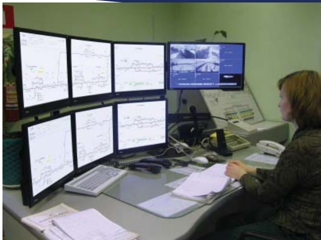
Оборудованное рабочее место дежурной по станции
