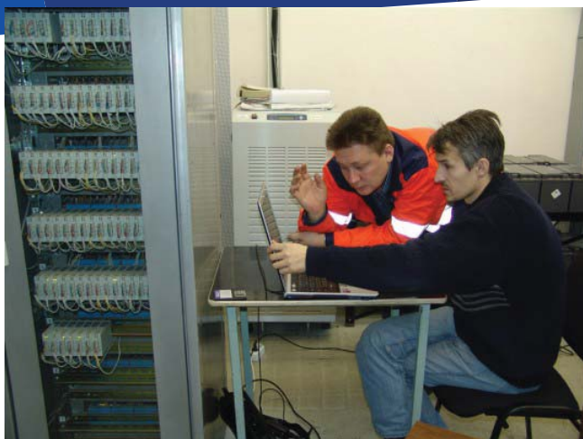
Проведение пусконаладочных работ МПЦ-И на ст. Асфальтная (Южно-Уральская железная дорога, 2005 год)
