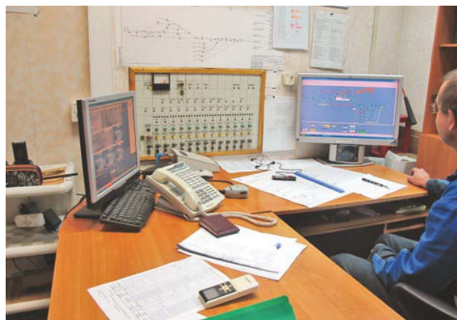
Ввод МПЦ-И второго поколения в постоянную эксплуатацию (ст. Тонкий Лист ОАО «Магнитогорский металлургический комбинат»), 2001 год
