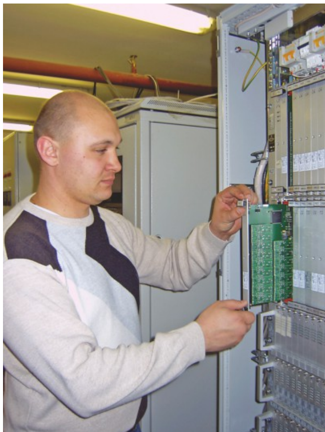
Сервисное обслуживание наших систем на объекте
