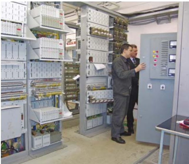
Включение системы МПЦ-И в опытную эксплуатацию на ст. Асфальтная (2005)
