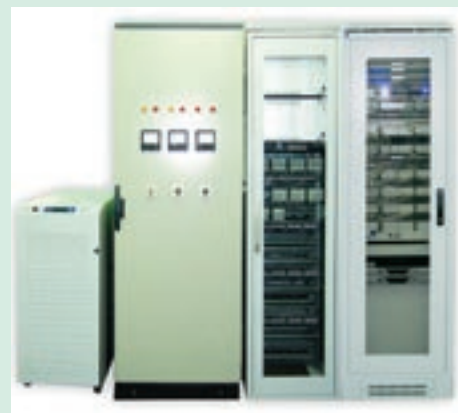
Постовое оборудование системы микропроцессорной централизации МПЦ-И
