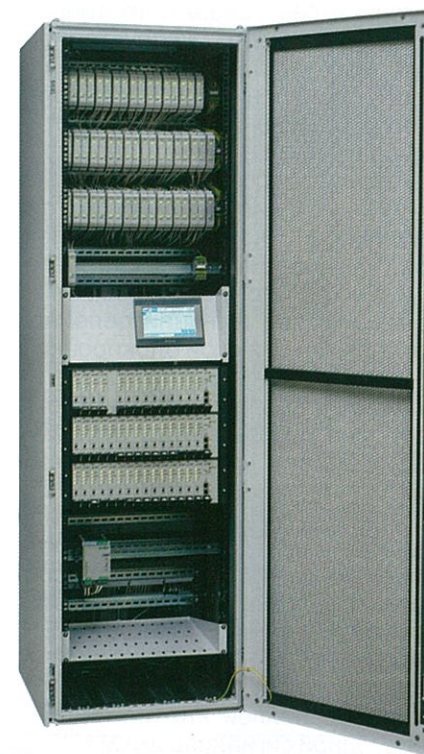
Постовое оборудование ЭССО-М
