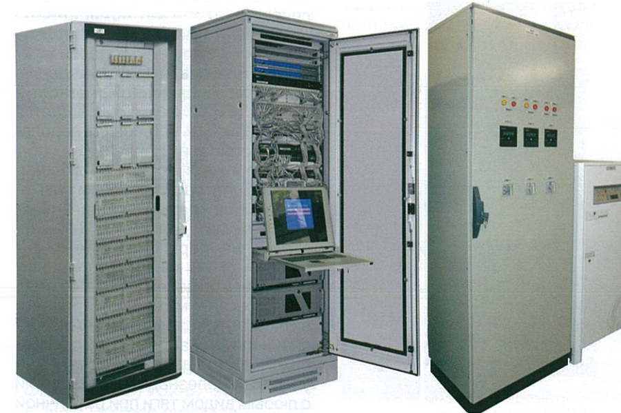
Оборудование системы МПЦ-И
