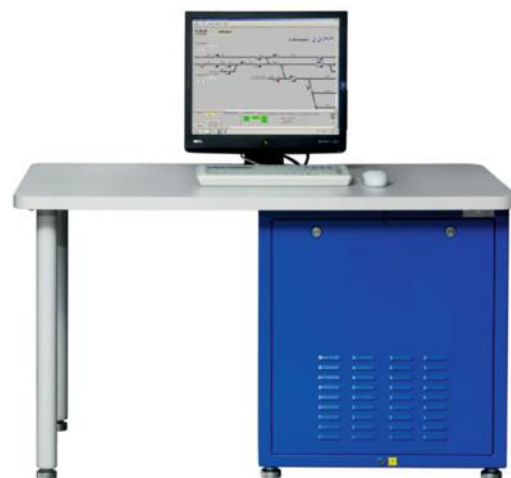
Автоматизированное рабочее место электромеханика АРМ ШН
