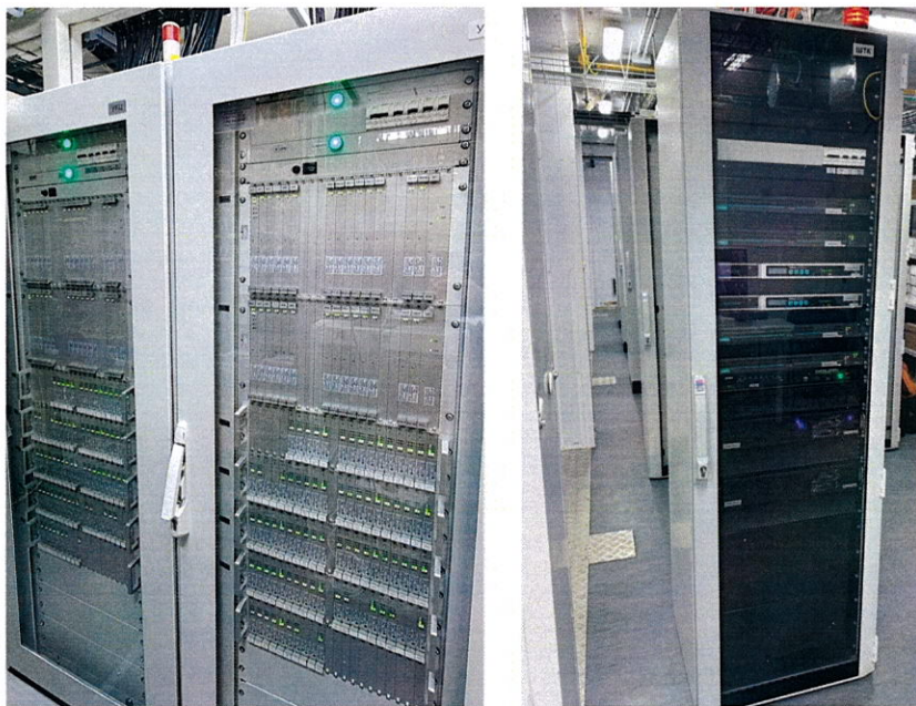
Резервированный УКЦ (слева) и шкаф телекоммуникационный ШТК (справа)
