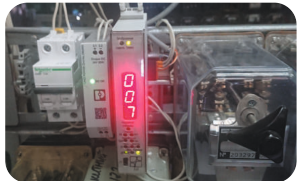
BI Interfacing Unit
