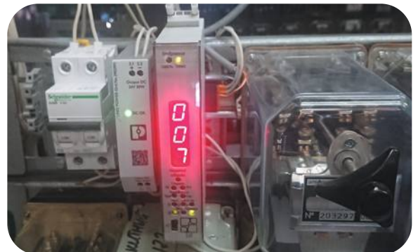
BI Interfacing Unit
